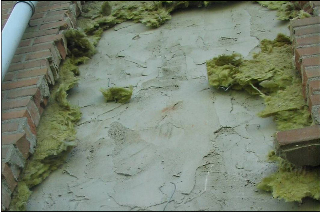
Figuur 3. Bij deze blootgelegde spouwmuur is een voor vlemuizen goed (ruw) afgewerkte muur te zien, maar door het contact met het isolatiemateriaal is deze ruimte zo goed als ongeschikt voor vlemuizen; door ruw plaatmateriaal tegen het isolatiemateriaal te bevestigen ontstaat een voor vlemuizen geschikte verblijfplaats.
